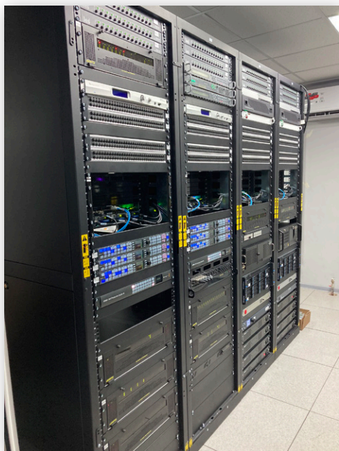
Стойки с оборудованием в новом машинном зале
