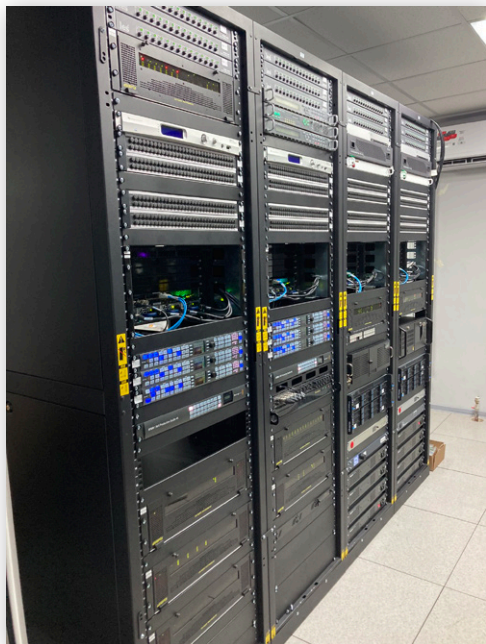
Стойки с оборудованием в новом машинном зале
