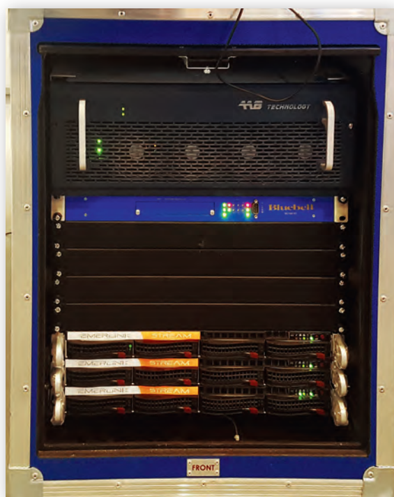
Стойка с технологическим оборудованием
