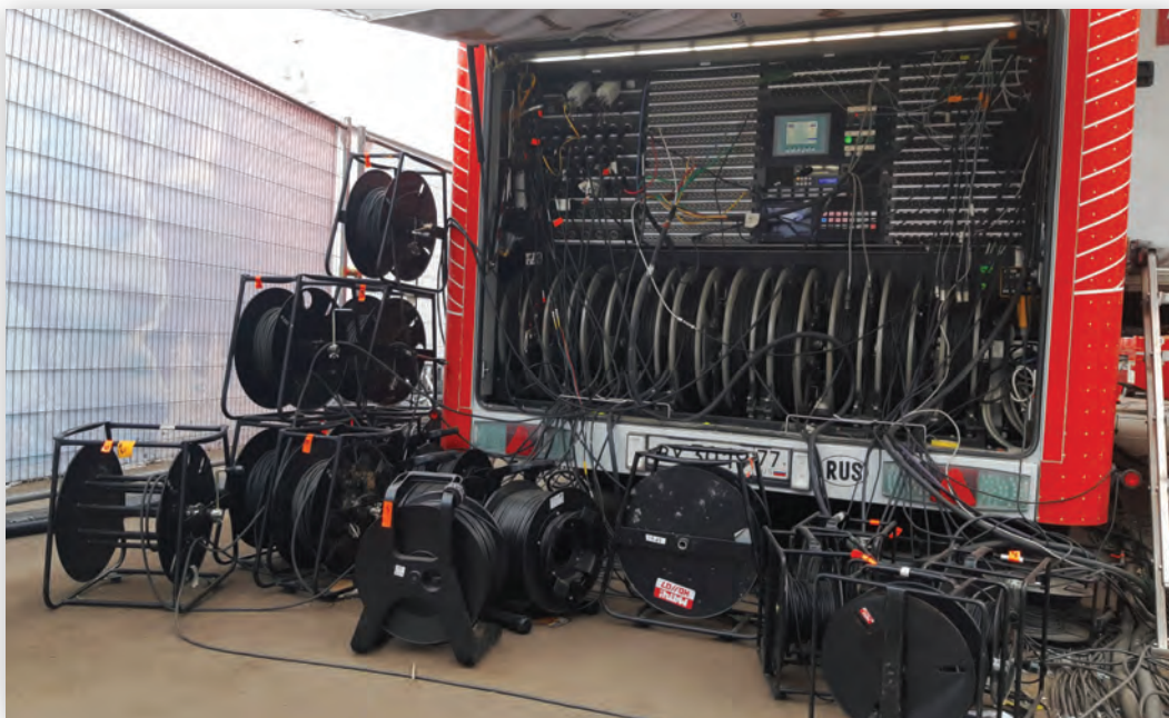
Кабельные сборки Om Network, обеспечивающие коммутацию ПТС во время трансляции церемонии закрытия Универсиады 2019
