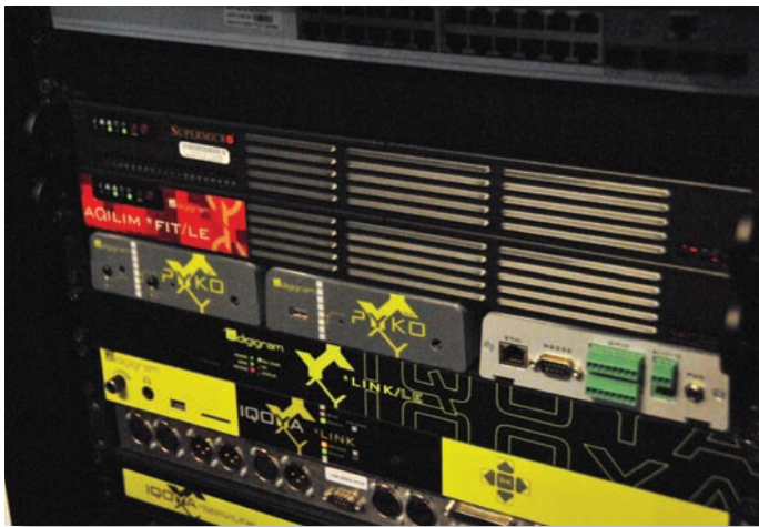
Стойка с оборудованием Digigram. Верхний прибор - видеокодер AQILIM *FIT/LE
