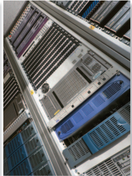
Стойки с новым оборудованием
