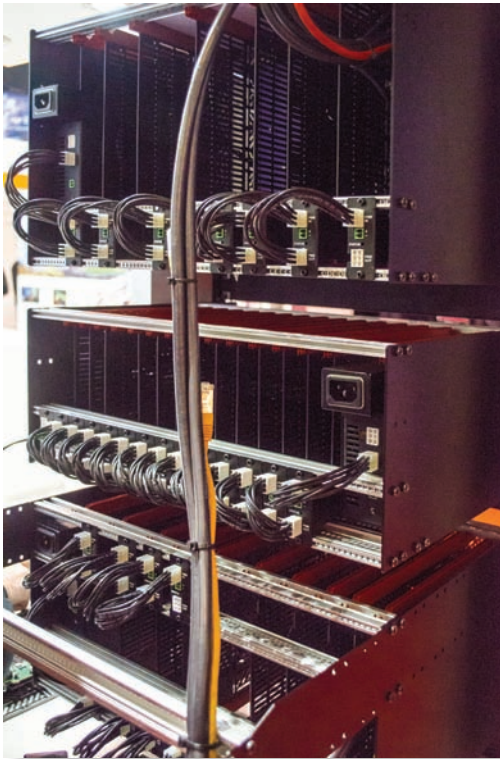
Модульные системы ONERack
