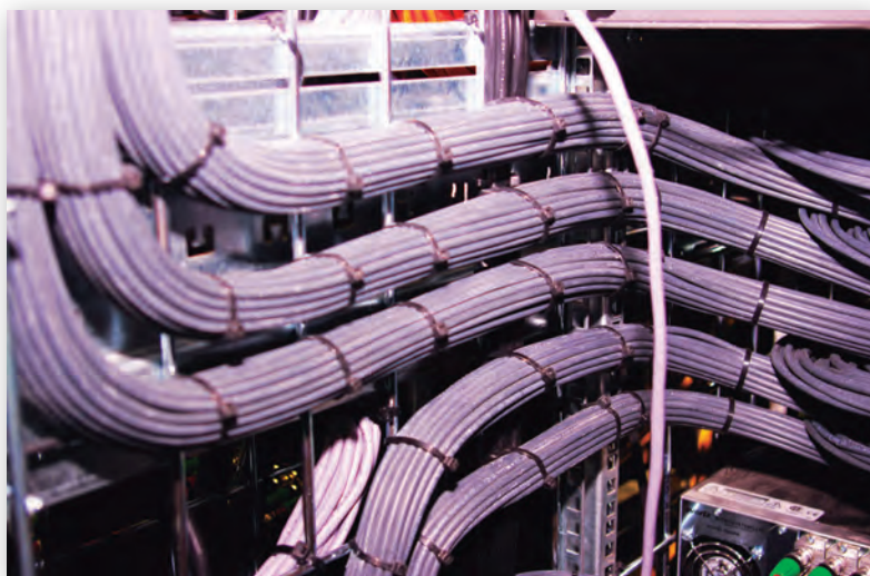
Рис. 2. Жгут кабелей внутри стойки
