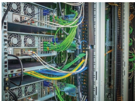
Серверы SkyLark SL NEO и другое оборудование в стойке
