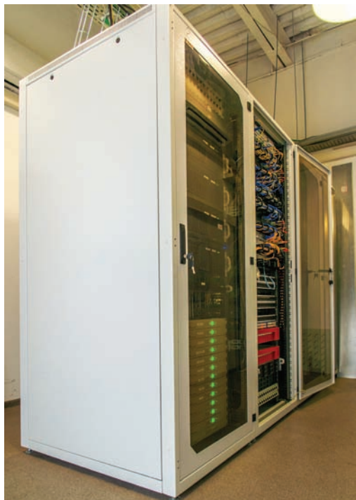
Шкафы с технологическим вещательным оборудованием
